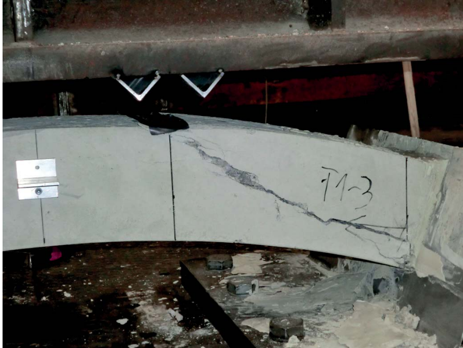
Abbildung 130 Foto des Bruchbildes von Tübbing T1-3
