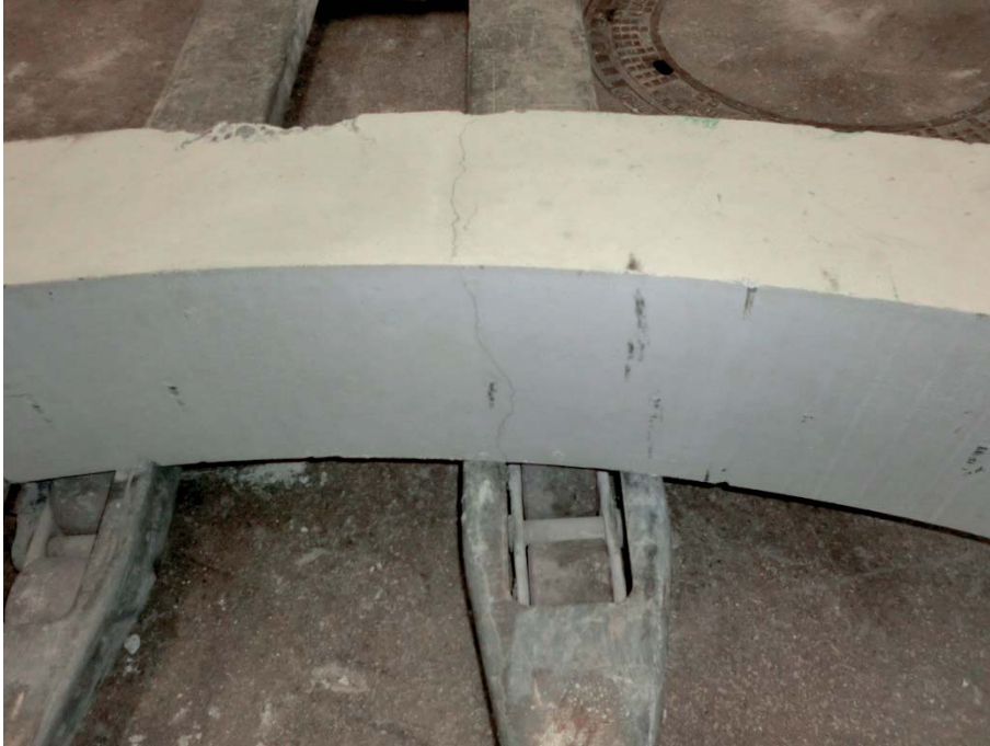
Abbildung 154 Vorschädigung des Tübbings T2-9 (Querriss in der Mitte)
