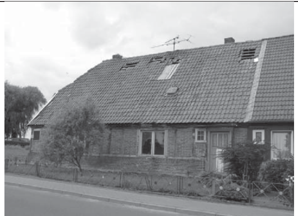
Abbildung 11 Verfallendes Haus mit defektem Dach in Schönhausen (Vorpommern)
