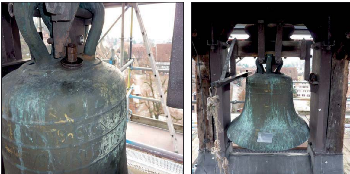
Abbildung 3: Kloster Maulbronn, Glocke vor der Abnahme mit Aufhängungsschaden und ausgeschlagenem Schlagring. Die Glocke wurde wegen ihres historischen Werts abgehängt und ein Nachguss angefertigt. Die Glocke hängt nun in einem separaten Glockenstuhl im Inneren des Klosters.
