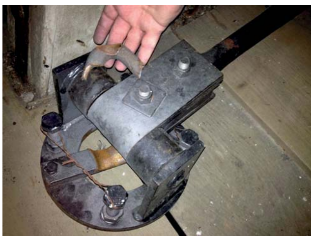
Abbildung 5: gebrochene Klöppelöse, an Glockenboden abgescheuert. Die enormen Querschnitte müssen nicht sein.
