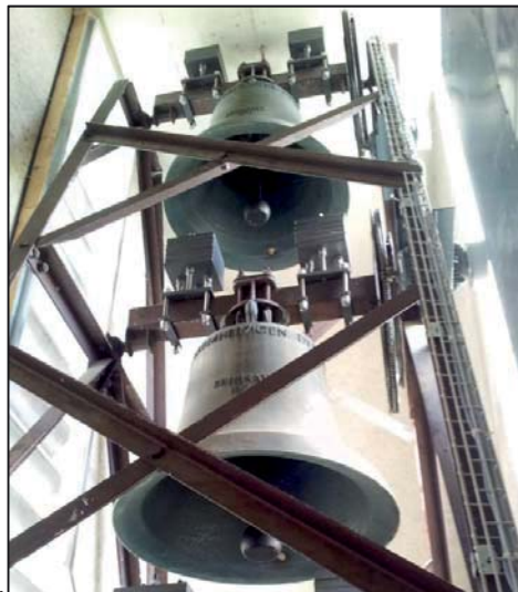
Abbildung 21: Die zunächst nach gewohnter Manier ausgerüstete Glockenanlage des ökumenischen Zentrums Kehrsatz bei Bern im Zustand nach einer Sanierung mit dem Ziel der Schallpegelsenkung: Obergewichte auf den Jochen verlangsamten den Läuterhythmus, die Klöppel werden durch die Trägheit im Schwungsystem und komplette Entfernung der Vorschwünge zu Fallklöppeln
