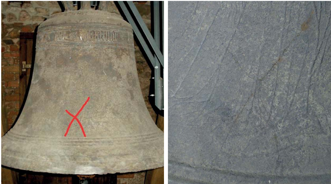
Abbildung 10: Position der Risse (links), Risse im Detail (rechts)
