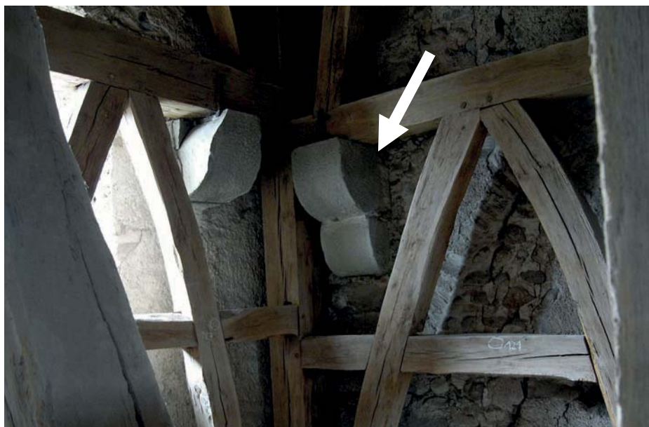
Abbildung 2: Beschädigung der Auflager aus Sandsteinkonsolen
