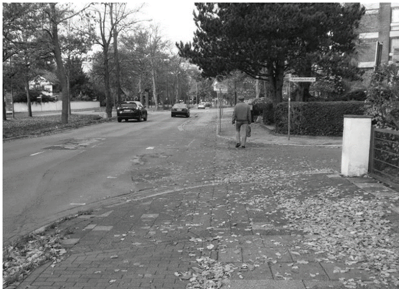
Abb. 3 Fehlende bzw. stark abgefahrene Furtmarkierung in Bremen
