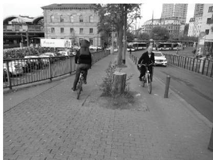
3. Radweg im Zweirichtungsbetrieb (einseitig) mit 1,6 m weit unter Mindestbreite (2 m); zusätzlich extreme Engstellen durch Bäume (Restbreite 0,7 m. Mainz)
